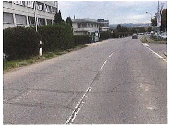
Figure 9 : Rte de Préverenges – Réparations, faïençage
