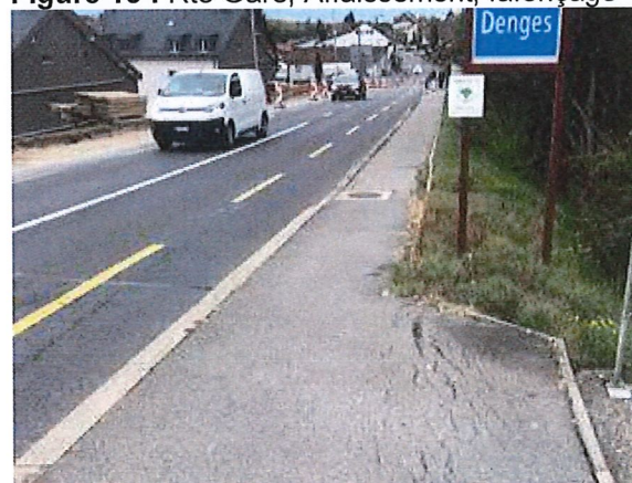
Figure 17 : Rte Gare, Trottoir Ouest - Affaissement
