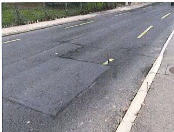
Figure 14 : Rte Gare, Réparations, fissures
