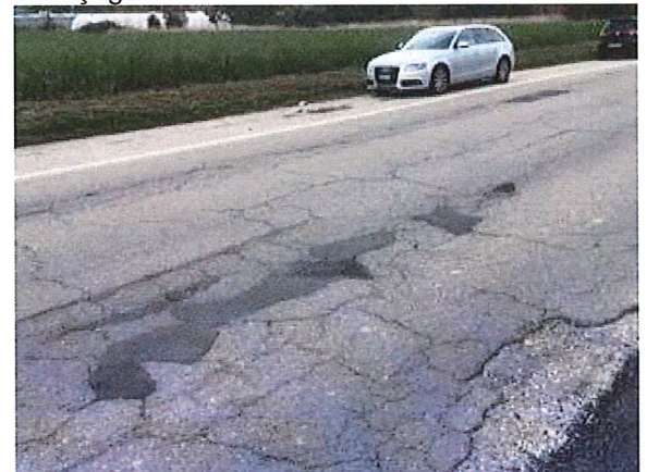
Figure 11 : Rte de Préverenges – Faïençage pelades et réparations
