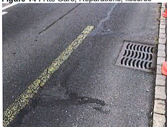
Figure 16 : Rte Gare, Fissures pontées
