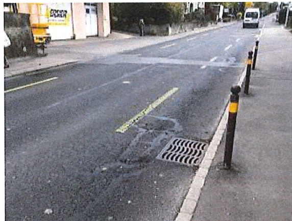
Figure 15 : Rte Gare, Affaissement, faïençage
