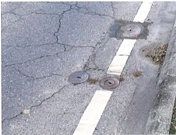
Figure 8 : Rte de Préverenges - Faïençage
